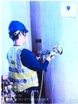
◎1 5#生活垃圾焚烧炉
