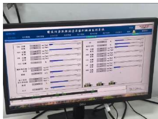
焚烧废气在线监测系统（已联网）
