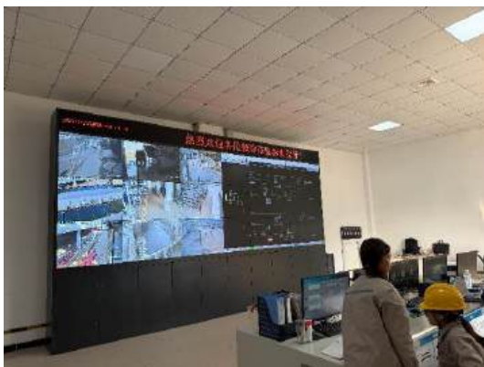
渗滤液处理站监控系统
