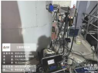
◎6#生活垃圾焚烧炉
