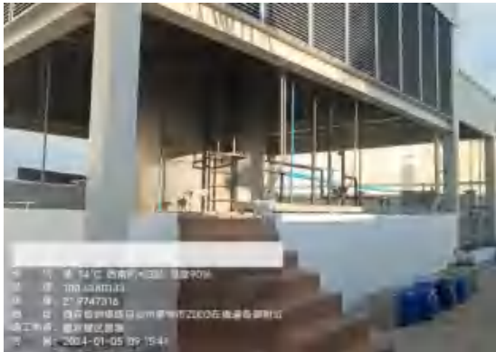
氨水罐区围堰
