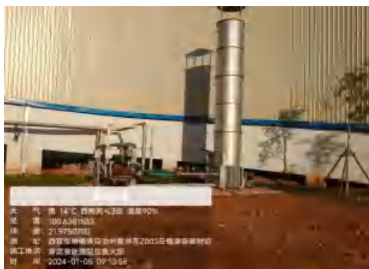
渗滤液处理站应急火炬
