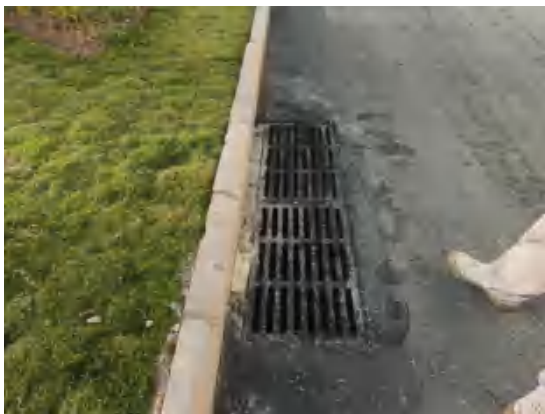
厂区雨污分流排水系统
