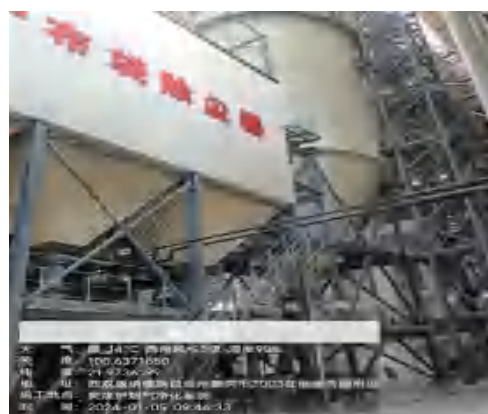
焚烧炉烟气净化系统
