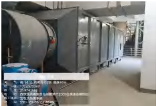
活性炭除臭系统
