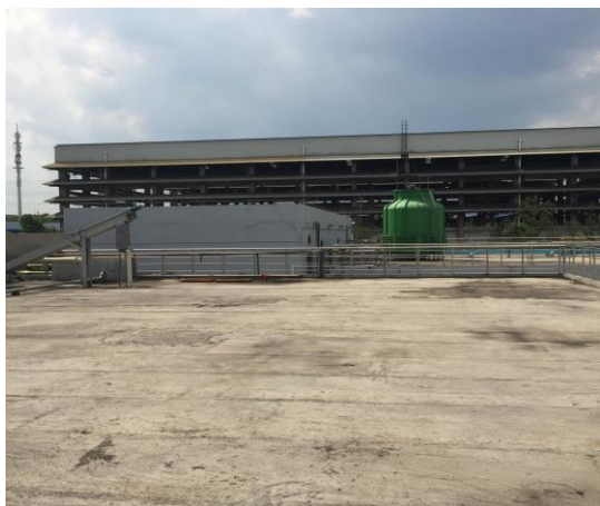
渗滤液处理站
